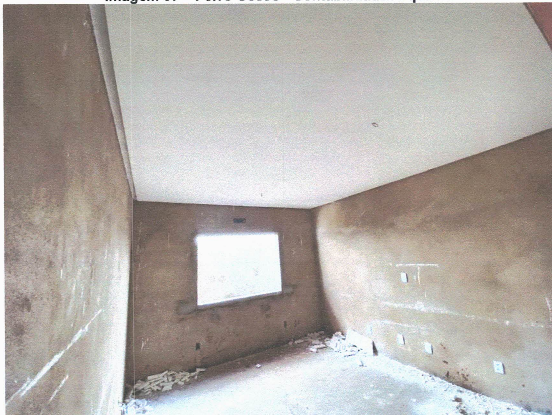
Imagem 07 – Forro Gesso - Contabilidade/Arquivos
